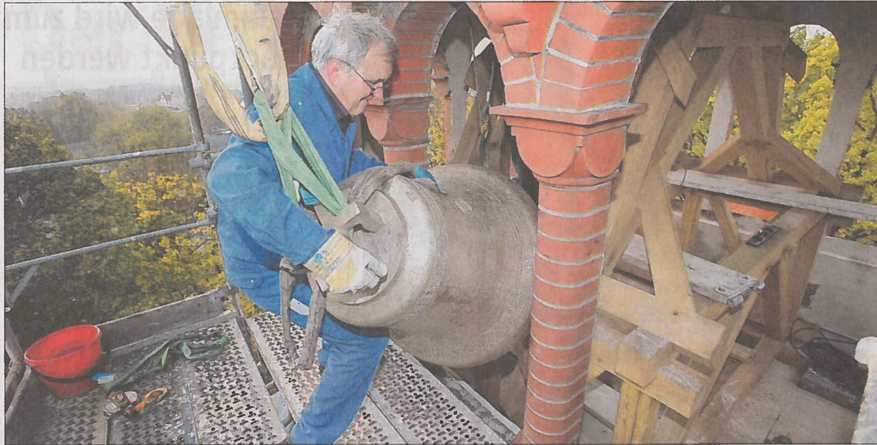
Hat der Kraft: Was nicht zu sehen ist, dass die Glocke mit Hilfe eines Flasenzuges, der anstelle des Klöppels angebracht wurde, in den Turm gezogen wird. Fachmann Günther Musholt balanciert die Glocke. Teile der Pfeiler mussten extra abgeflexelt werden. Fotos (2) MOZ/Gerd Markert
